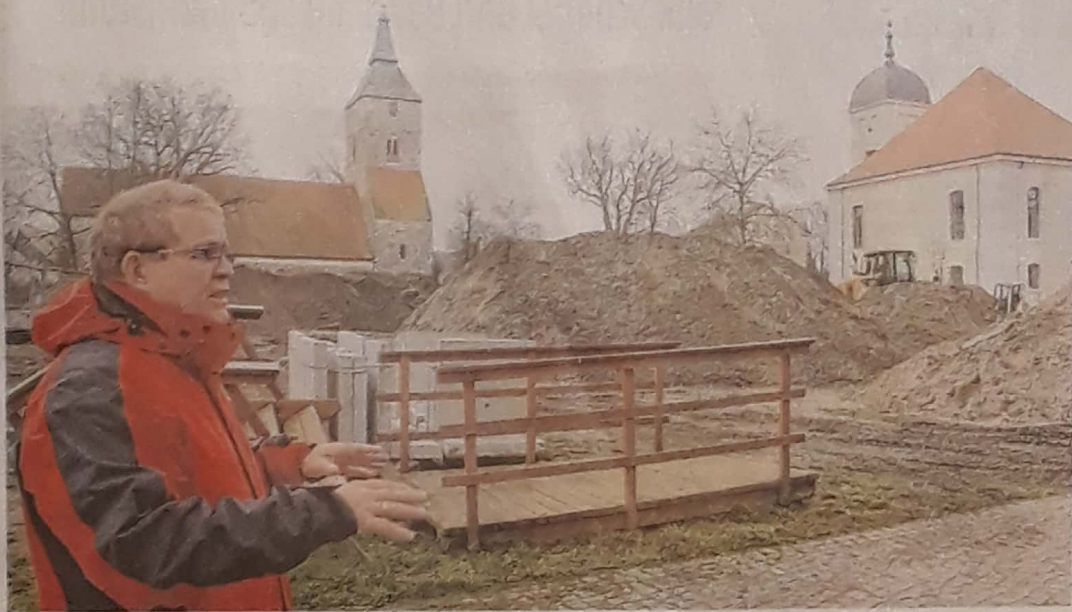
Frank Ruppertsberger, einer der Geschäftsführer der Schlossgut GmbH, ist mit dem erreichten Sanierungs-/Baufortschritten 2017 zufrieden – sofern das Wetter mitspielt, soll es mit den Arbeiten auch ohne Winterpause weitergehen.
